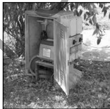
ESEMPIO DI LOCALE TECNICO
